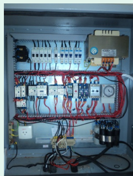
Quadro de Comando
