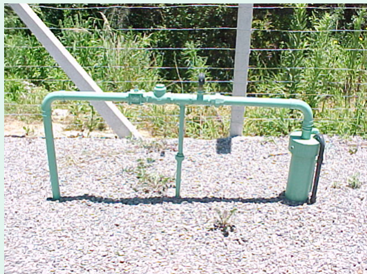
Poço e Barrilete
